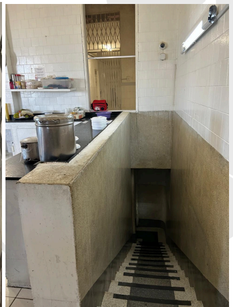
Escada interditada na cozinha
