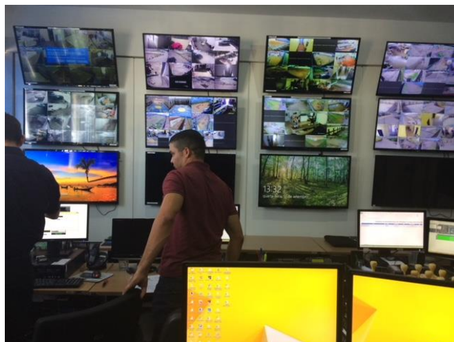
Sala instalada na sede da SEAP, onde é feita a monitoração eletrônica e o monitoramento, por câmeras, das principais unidades prisionais do Estado
