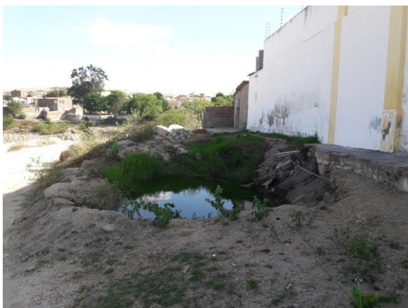
Esgoto a céu aberto – Cadeia Pública de Pocinhos
