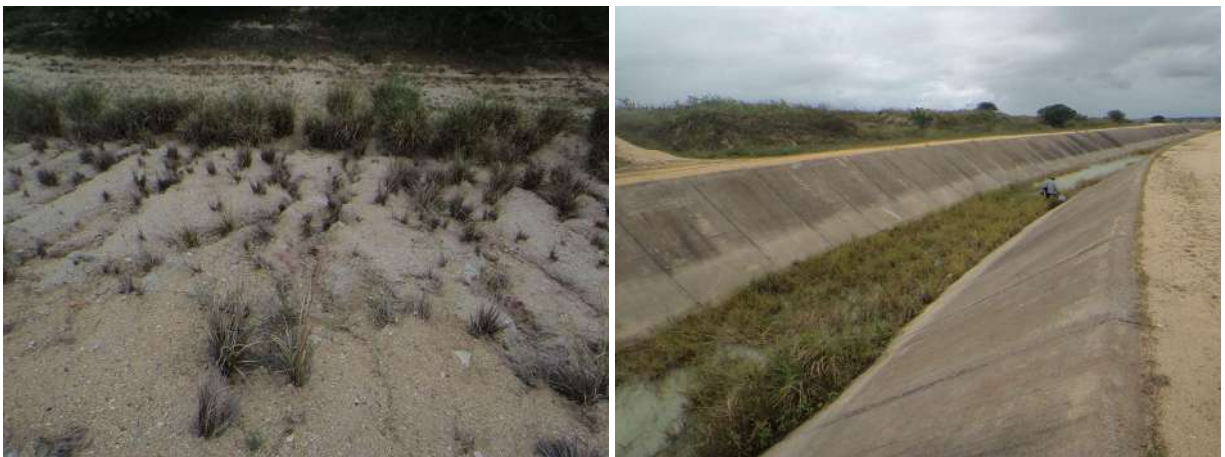
(a) Canal Adutor - Segmento 3 (E1037 a E2041): Erosão no talude lateral do Canal. (b) Canal Adutor - Segmento 3 (E1037 a E2041): Vegetal na laje de fundo do Canal (E1421).
