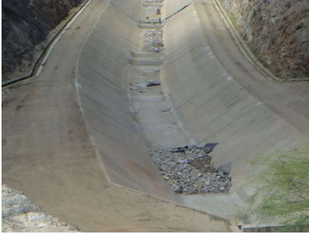
(a) Canal Adutor (Segmentos: 2A; 2B e 2C): Canal em Placas Concreto com rachaduras e/ou danificadas.
