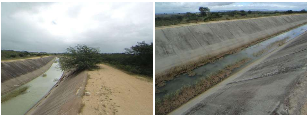
(c) Canal Adutor - Segmento 3 (E1037 a E2041): arbusto na berma do canal, (E1436). (d) Canal Adutor - Segmento 3 (E1037 a E2041): Vegetação na laje de fundo do Canal.
