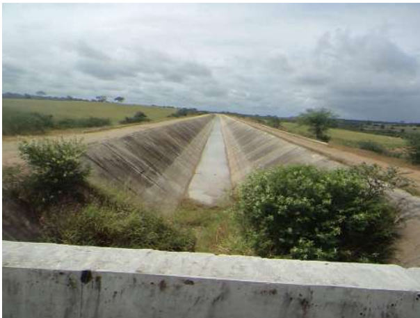
(c) Canal Adutor - Segmento 3 (E1037 a E2041): vegetação de médio porte indicando a ausência de manutenção no trecho.
