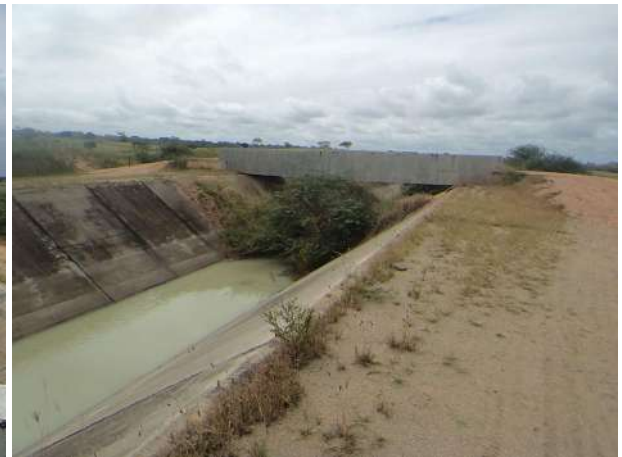
(d) Canal Adutor - Segmento 3 (E1037 a E2041): vegetação de médio porte indicando a ausência de manutenção no trecho.
