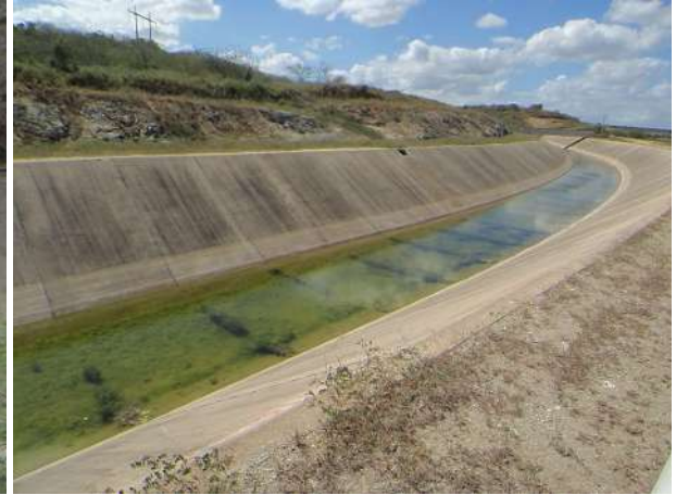
(b) Canal Adutor (Segmentos: 2A; 2B e 2C): Vegetação na laje de fundo do canal danificando a drenagem sob o fundo do canal.
