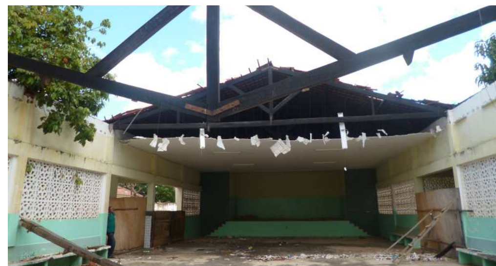
Situação de abandono encontrada, à época em que foi feita a auditoria operacional de educação, numa área da escola Obdúlia Dantas, na cidade de Catolé do Rocha.
