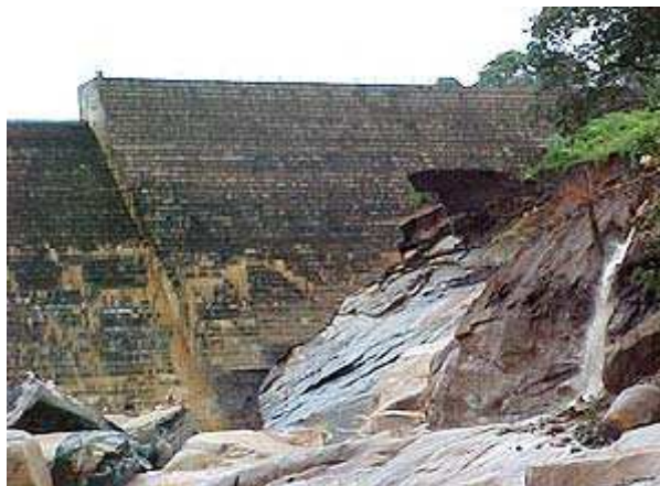
Foto 17 - Aspecto da ruptura da fundação da barragem, vista de jusante.
